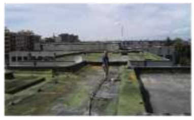
Scarsa superficie permeabile
